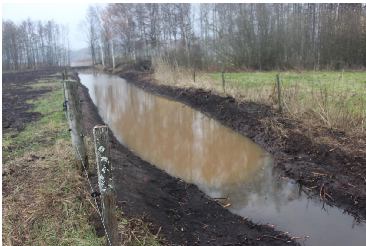
Den senaste i raden av åtgärder, hösten 2020. Fosfordamm och tvåstegsdike på Väsby. Foto: C-J Natur
